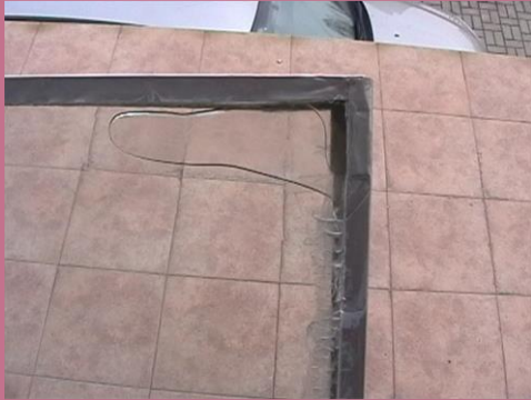
Bild 6.1 – Defekt durch Wasserschaden
