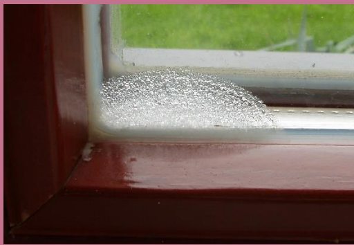
Bild 6.2 – Defekt durch Wasserschaden
