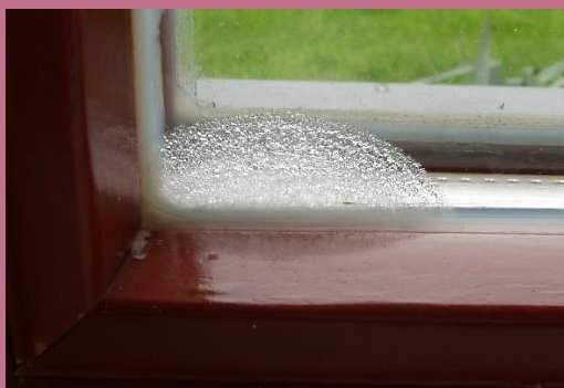
Rys. 6.2 – Wady spowodowane przez wodę
