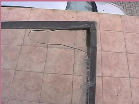
Rys. 6.1 – Wady spowodowane przez wodę
